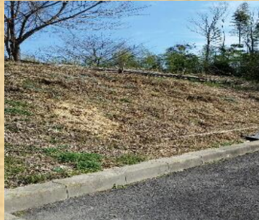
荒らされた法面2
