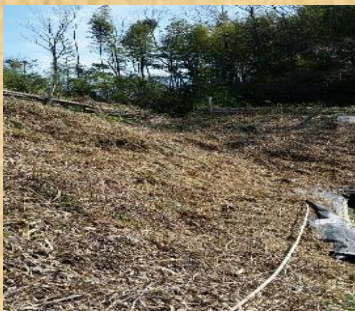
荒らされた法面1
